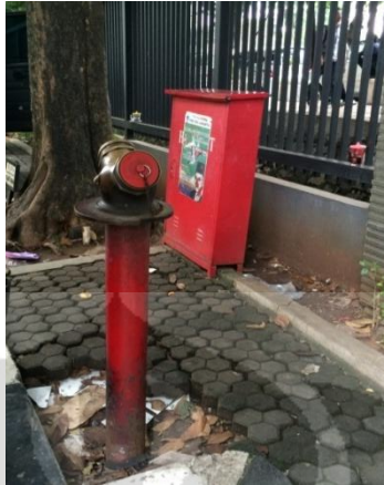
Gambar 6.36. Sistem Hidran di Luar Gedung SMA Labschool Jakarta
