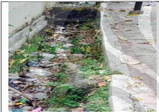
Drainase Kondisi Buruk
