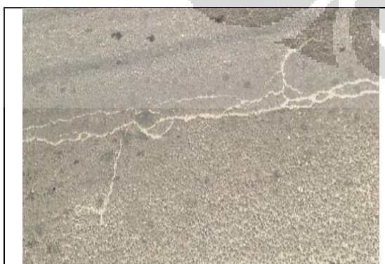
Kerusakan Jenis Retak Halus
