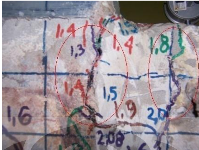
Gambar 4.47 Kegagalan Berupa Retak Lentur Pada Daerah Pertemuan Balok Kolom Dan Sambungan Beton Dengan Material Perbaikan M-5.2
