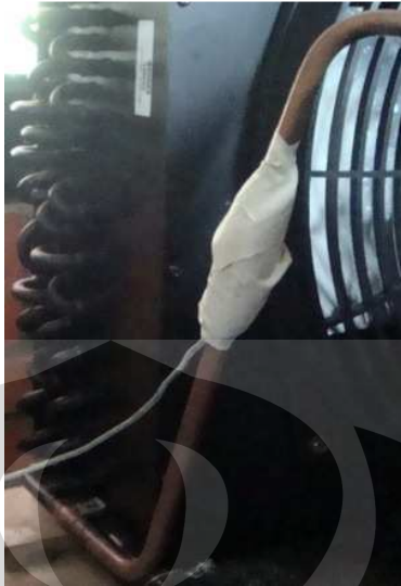
Gambar 3.40. Thermocouple pada Outlet Kondenser
