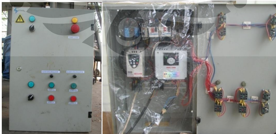
Gambar 4.7 Control panel yang Digunakan untuk Feeder dan Blower
