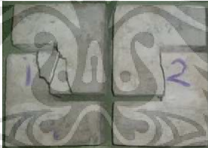
Gambar 37 : Pola Keretakan Tegangan Geser
