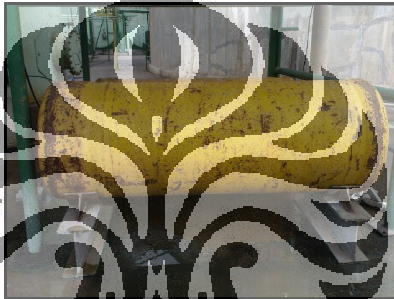
Gambar 6.1. Chlorine Ton Container pada Unit Water Treatment
