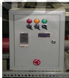
Gambar 3.14 Panel Sistem Listrik
