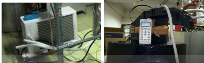
Gambar 3.4 Air Conditioner dan Controller-nya
