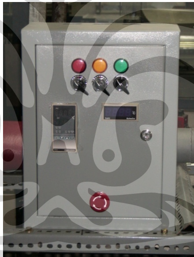
Gambar 3.13 Panel Sistem Listrik
