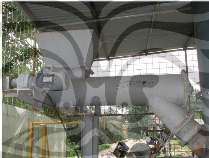
Gambar 3.12 Sistem Feeder pada Fluidized Bed Combustor UI.
