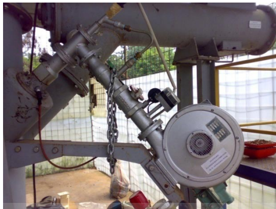
Gambar 2.12 Burner yang Digunakan pada Fluidized Bed Combustor UI
