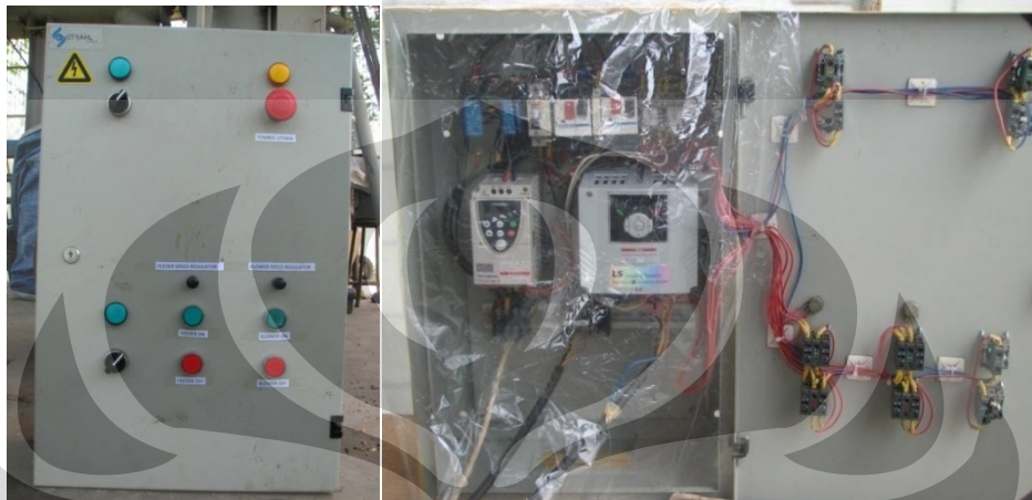
Gambar 3.10 Control panel yang Digunakan untuk Feeder dan Blower
