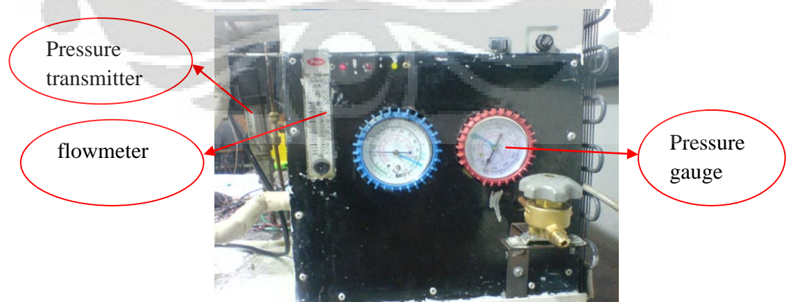
Gambar 3.7 Penempatan pressure transmitter, flowmeter dan pressure gauge
