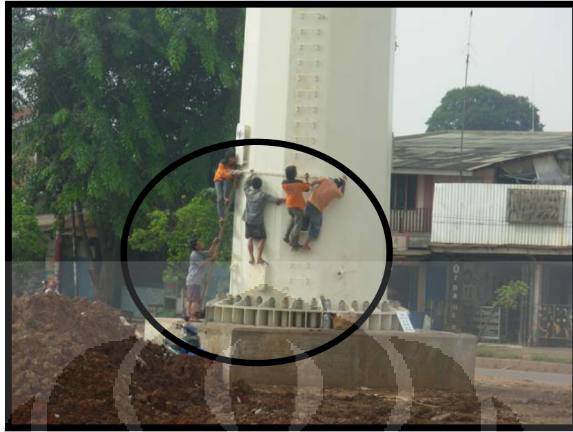
Gambar 5.9. Pekerja Yang Tidak Memakai Alat Pelindung Diri (APD) Secara Lengkap Pada Pekerjaan Pemasangan Rambu Pada Tiang Tegangan Tinggi Sumber: Dokumentasi Pribadi (23 Desember 2009, Pukul 15.00-17.00)
