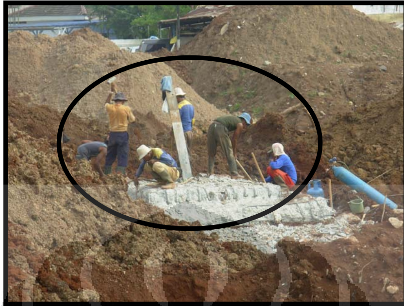
Gambar 5.17. Pekerja Yang Tidak Memakai Alat Pelindung Diri Secara Lengkap Pada Pekerjaan Penghancuran Pondasi Dinding Pengaman Pada Tiang Tegangan Tinggi
