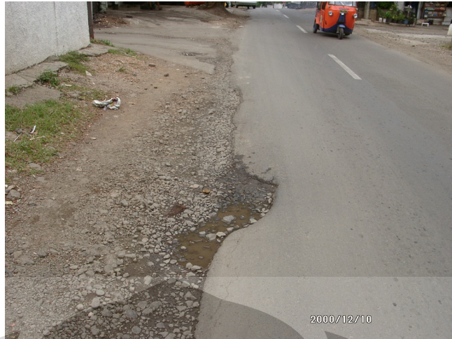
Gambar 2. 7. Pecah Tepi pada Perkerasan Aspal
