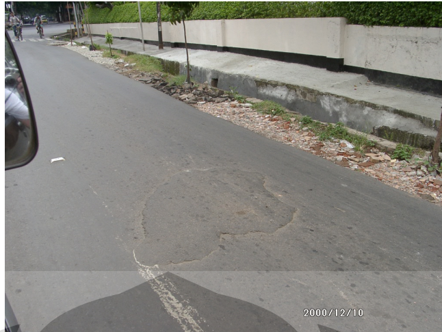
Gambar 2. 9. Tambalan pada Perkerasan Aspal
