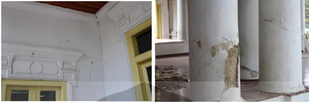
Gambar 4.65 Retak-retak Pada Elemen Dinding dan Kolom
