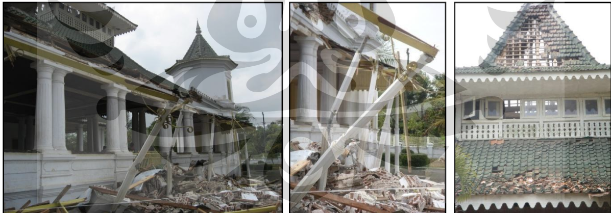
Gambar 1.2 Masjid Manonjaya (sesudah terjadi gempa)
