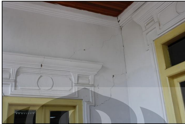
Gambar 4.54 Kegagalan Pada Titik 1 di Lapangan
