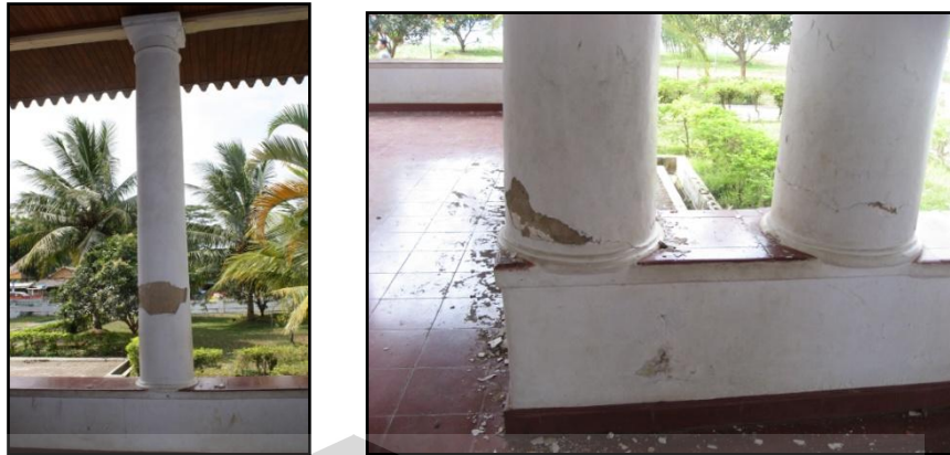
Gambar 4.49 Kegagalan Pada Kolom Perimeter (Tepi Luar)
