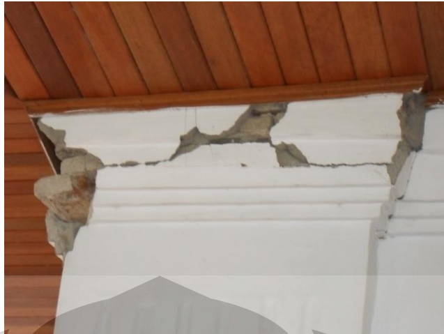
Gambar 4.60 Kegagalan Pada Titik 4 di Lapangan
