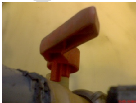
Gambar 3.2.5 Sistem bukaan katub pada reservoir utama
