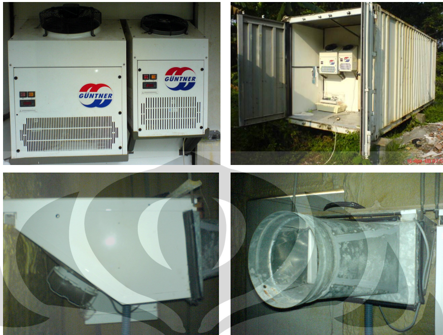
Gambar 3.6 Letak alat Plug-In refrigeration unit GEKN 1200
