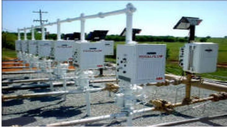
Gambar 2.3 Suatu manifold pada produksi gas onshore
