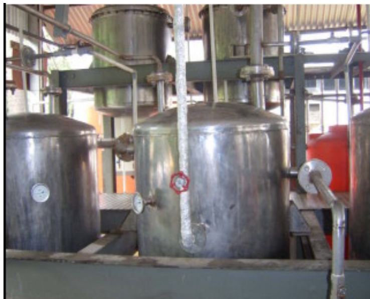
Pabrik Biodiesel PT. Alternatif Indonesia Kapasitas 1.500 liter/hari
