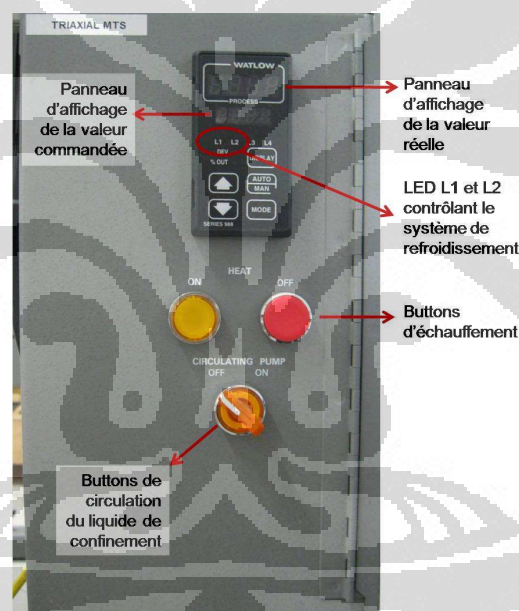
Figure 2.11. Boîtier de puissance réglant le système de conditionnement de température.
