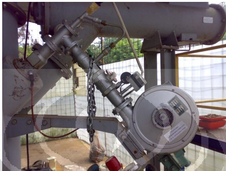
Gambar 2.15. Burner yang Digunakan pada Fluidized Bed Combustor UI
