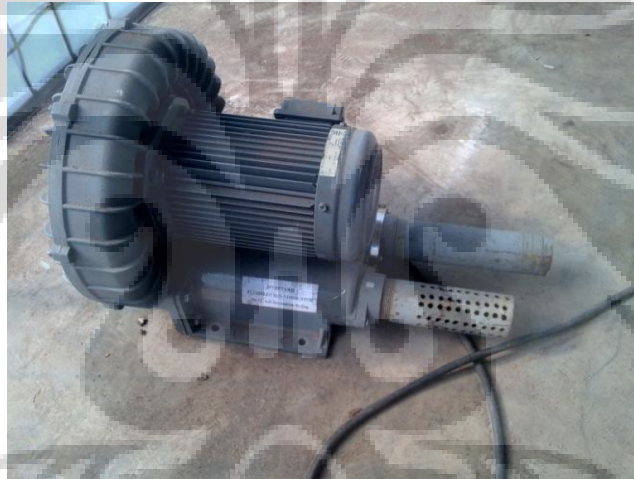
Gambar 2.17 Blower Sentrifugal yang Digunakan pada FBC
