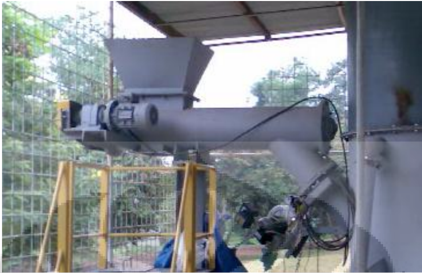
Gambar 3.12 Sistem Feeder pada Fluidized Bed Combustor UI
