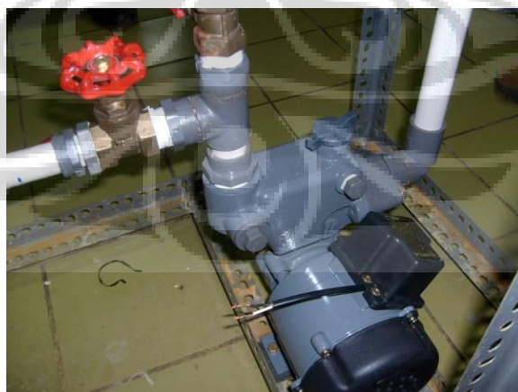
Gambar 3.10 Posisi pompa yang digunakan
