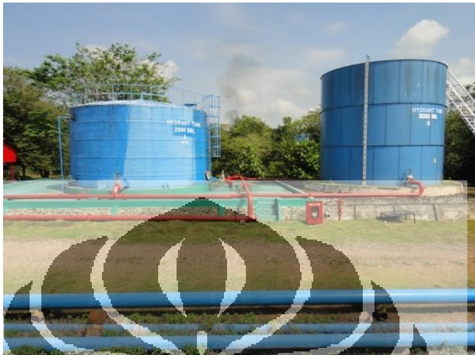
Gambar 6.5 Tangki air untuk Proteksi Kebakaran
