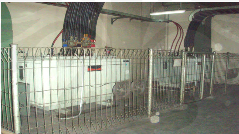
Gambar 3.1 Trafo Penurun Tegangan ( stepdown transformer ) 2000 kVA
