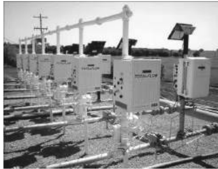
Gambar 2.3 Suatu manifold pada produksi gas onshore (1)
