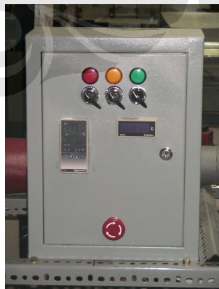
Gambar 3.12 Panel Sistem Listrik
