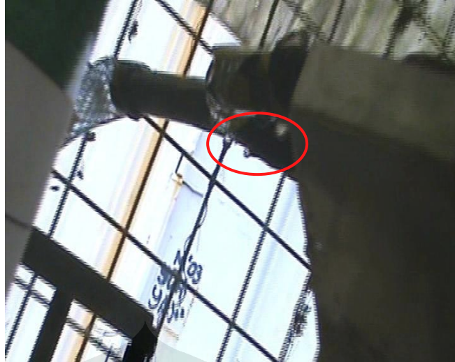
Gambar 5.1 Kebocoran air pada pipa cabang
