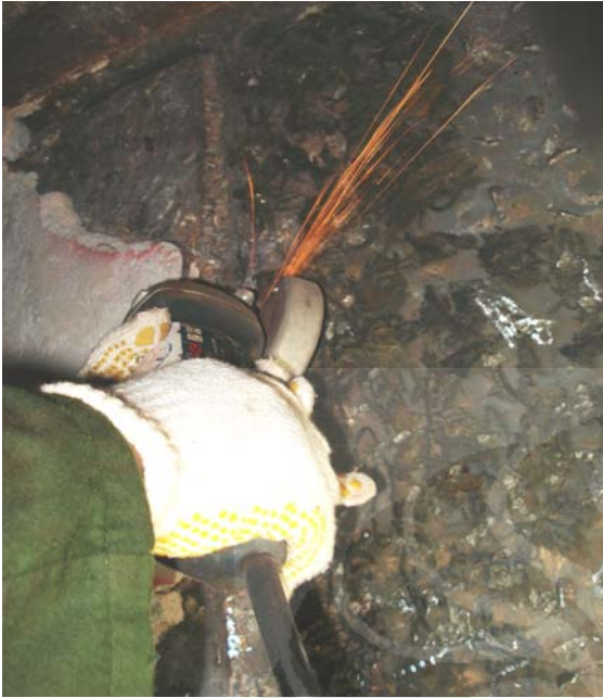
Prepared sebelum dilakukan pengambilan data Replika, Thickness dan Penetrant Test, area doubler.
