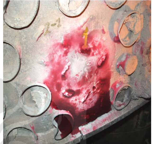
Penetrant Test dilakukan setelah Replika pada lokasi titik No.1 (72°/A) pada shell plenum material lama.
