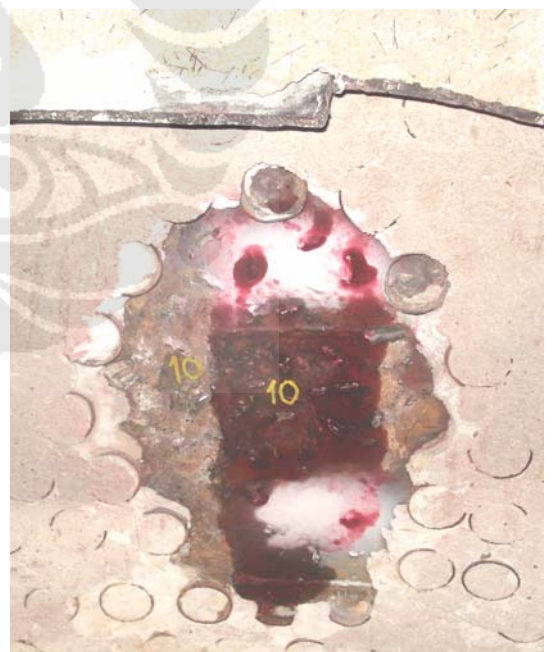
Titik No. 10 (252°/C-D) setelah dilakukan Penetrant Test pada lokasi shell plenum lama bagian atas header.
