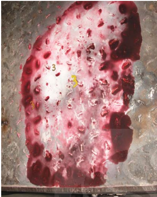
Titik No. 3 (144°/E) setelah dilakukan Penetrant Test pada lokasi shell plenum lama.
