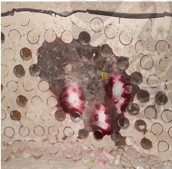
Titik No. 13 ( 108^\circ/\text{E-A} ) setelah dilakukan Penetrant Test pada lokasi shell plenum lama bagian atas header.
