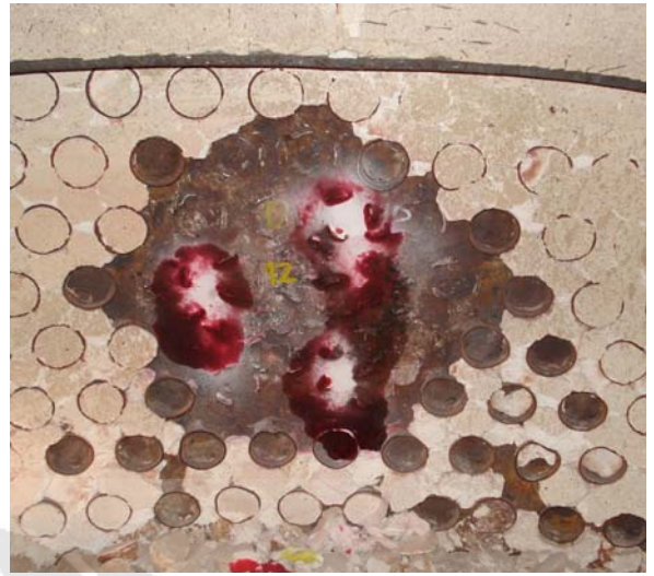
Titik No. 12 ( 36^\circ/\text{A-B} ) setelah dilakukan Penetrant Test pada lokasi shell plenum lama bagian atas header.
