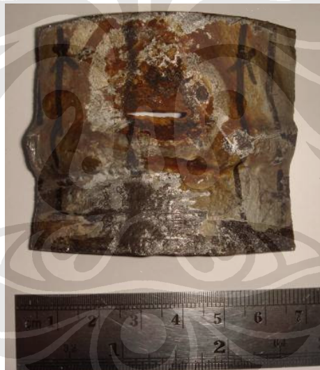
Gambar 4.5 Daerah bocor pada pipa
