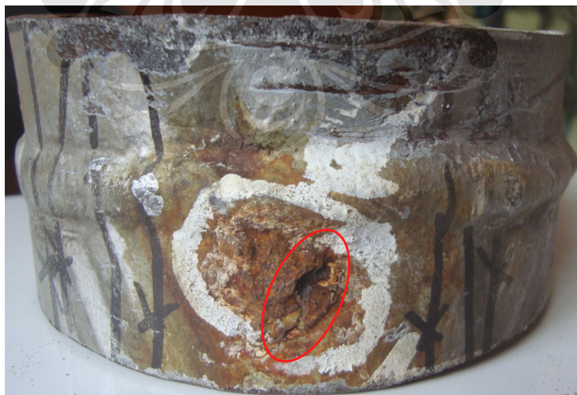
Gambar 4.3 Potongan sampel dengan penampakan luar dari leakage
