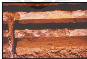
Gambar 2.5 Korosi Tanah pada Pipa Saluran (7)
