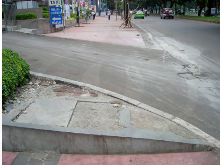
Gambar IV-17. Akses kendaraan bermotor ke Menara Sudirman memotong jalur pedestrian
