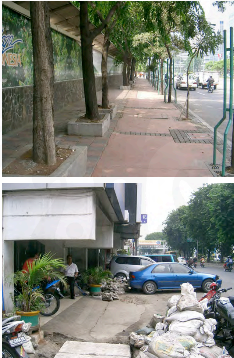
Gambar IV-2. Kondisi pedestrian pada jalan Thamrin (atas) dan Gajah Mada (bawah)
