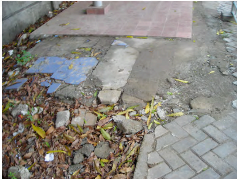
Gambar IV-41. Kondisi pedestrian di depan kavling kosong, tidak terpelihara
