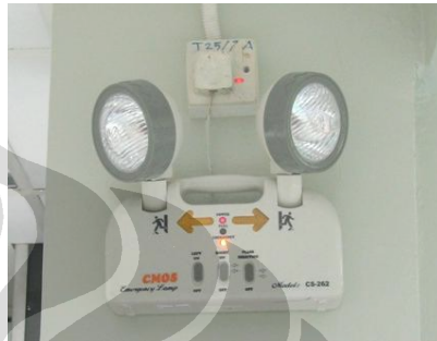
Gambar 6.14 Lampu Darurat Di Gedung PT. X Jakarta
