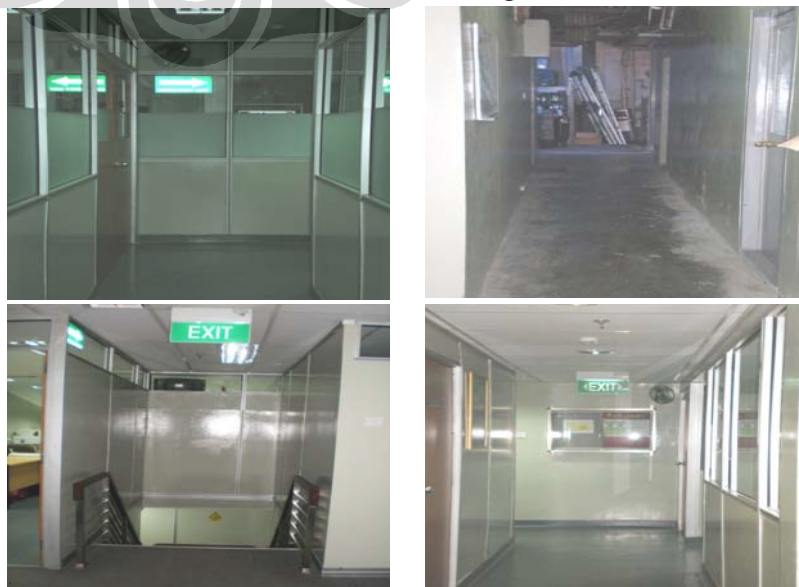
Gambar 6.12 Sarana Jalan Keluar Di Gedung PT. X Jakarta
