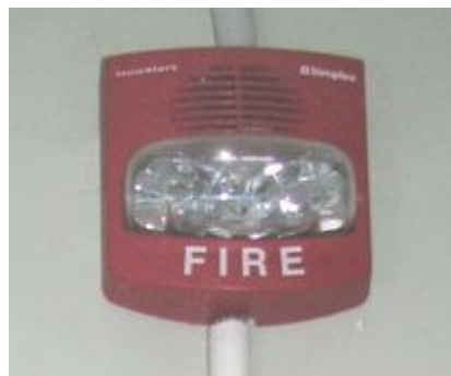
Gambar 6.5 Alarm Kebakaran Di PT. X Jakarta
