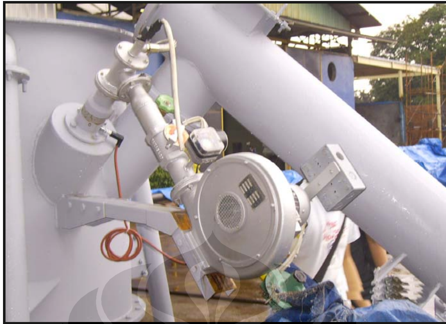
Gambar 4.12. Posisi terpasang burner pada lubang burner
