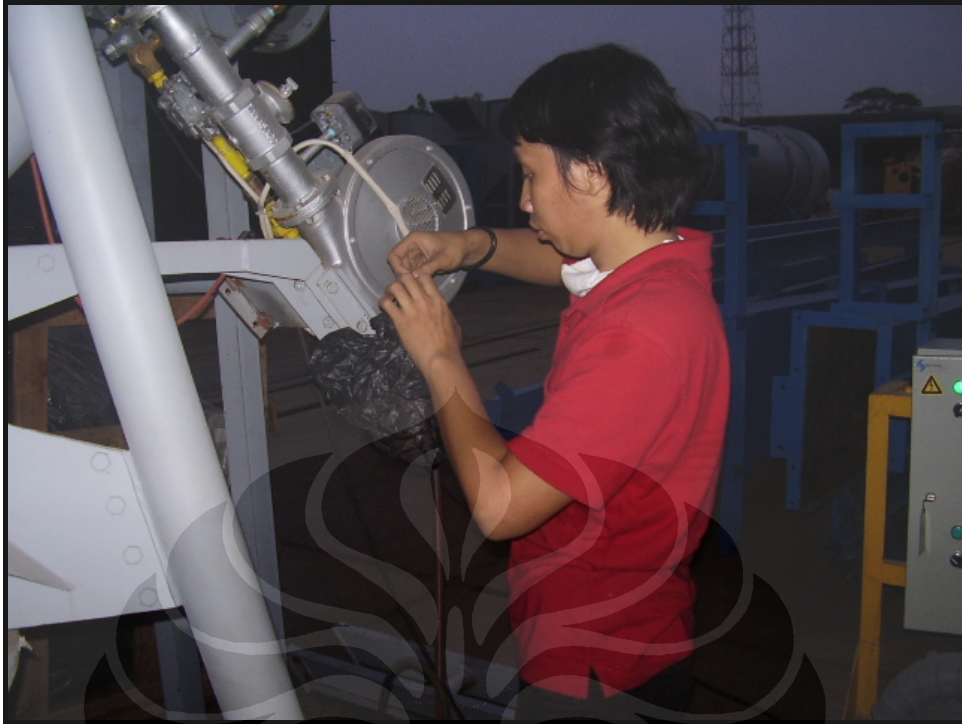
Burner terpasang pada reaktor
