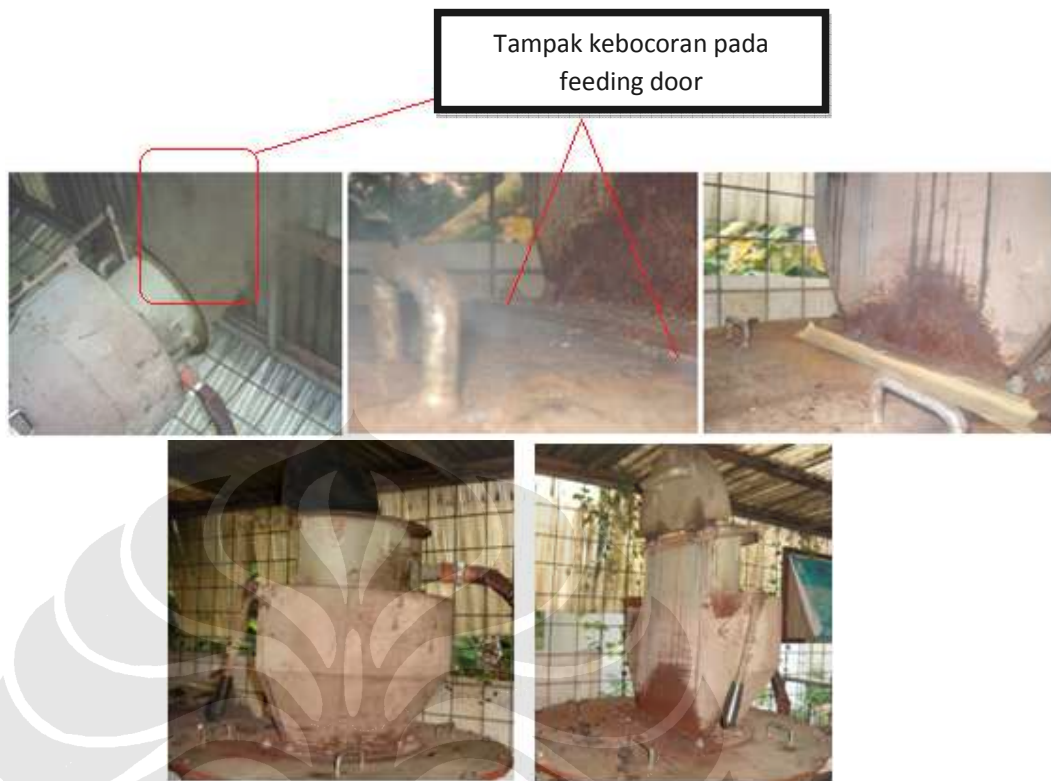
Gambar 3.1 Feeding Door dan Kebocoran yang Terjadi
