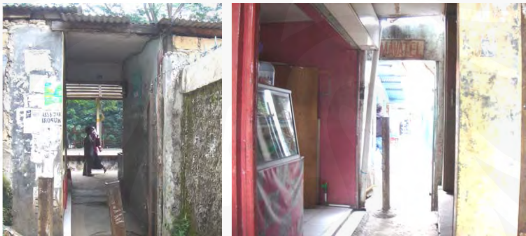
Gambar 21. Pintu-pintu kebocoran pada stasiun (sumber: dokumentasi pribadi)
