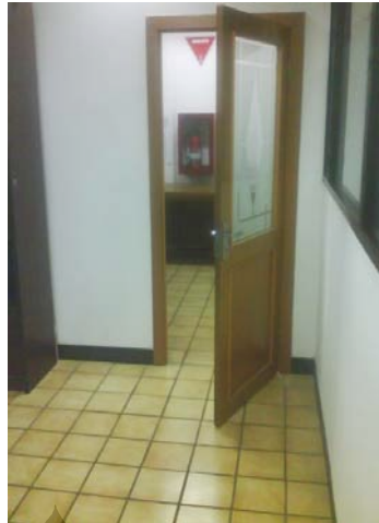
Gambar VI.2 Peletakan APAR yang Tidak Mudah Terlihat
