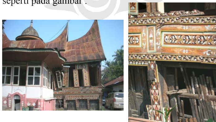
Gambar 5.76 Rumah Gadang Bodi Caniago Yang Terjadi Kerusakan Akibat Gempa
