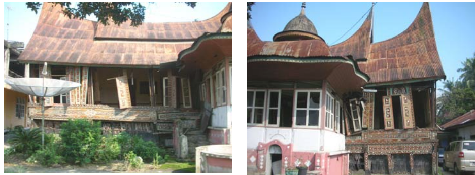
Gambar 2.30 Struktur Rumah Tradisional Sumatra yang Rusak Akibat Gempa
