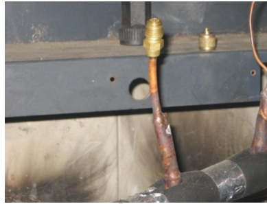
Gambar 4.15 Pentil pada pipa
