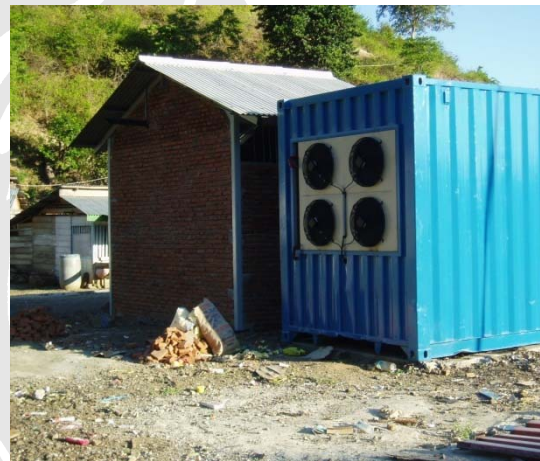
Letak condenser pada kontainer
