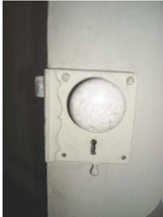
Foto 3.63. Gagang pintu pada ruang sakristi (Dok: Cheviano Alputila, 2008)
