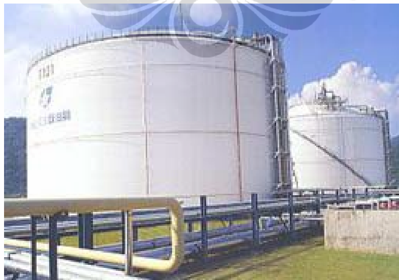
Gambar 2.12 Tangki LNG Full Containment (6)
