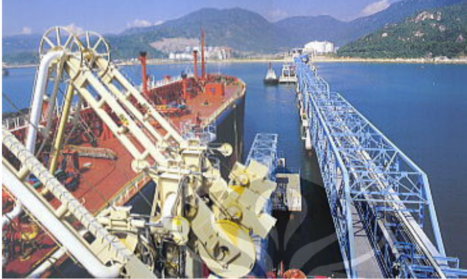
Gambar 2.11b Loading arm untuk pemuatan LPG ke kapal tanker
