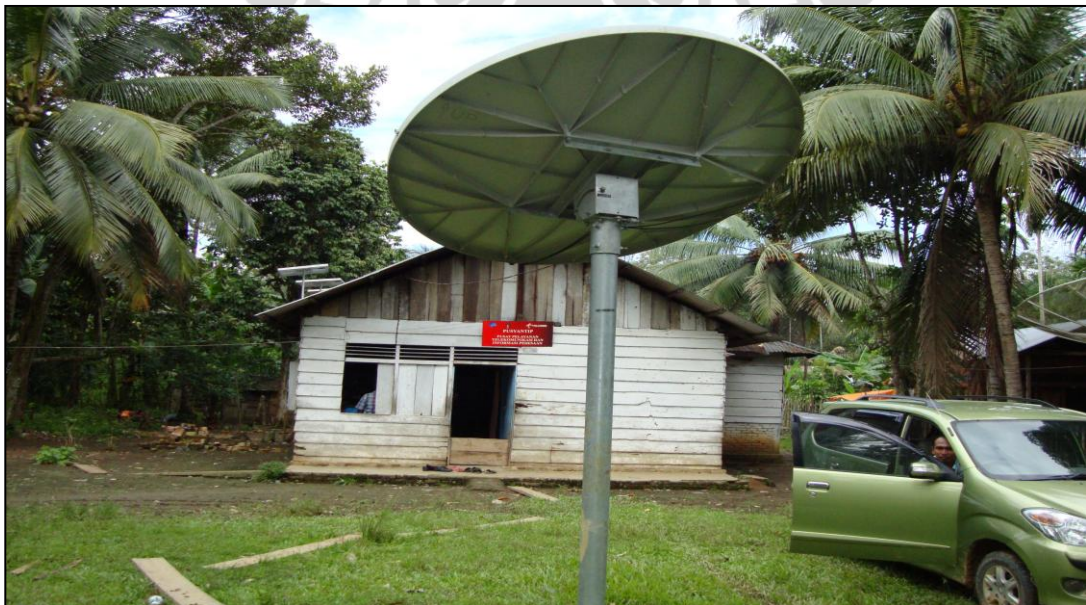
Antena VSAT & Perangkat Solar Panel Di Desa KPU/USO Kategori ST 3 B Desa Bulu Kasab, Kec. Maro Sebo Ulu, Kab. Batanghari, Propinsi Jambi.
