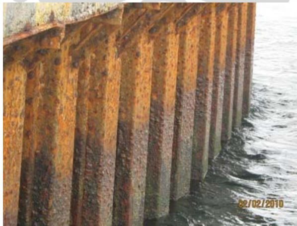
Gambar 2.4. Korosi merata pada Sheet Jetty Pile.
