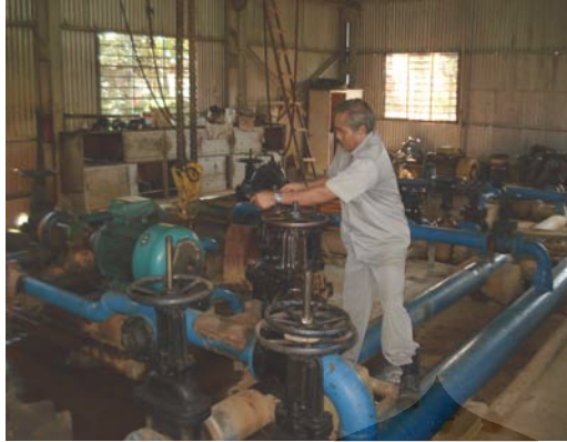
Foto 4.13 Mesin Pompa & Jaringan Pipa Air di Kampung Satu. (Foto: Salam 2010)
