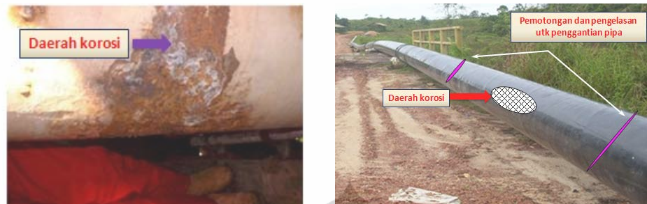
Gambar 1.1. Bagian pipa terkorosi & metode penggantian pipa yang terkorosi
