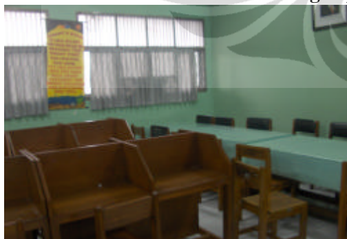
Gambar 4.8 Ruang baca duduk sebelum di renovasi
