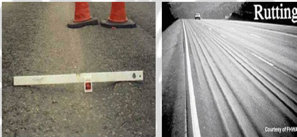
Gambar 2.6 Alur (Rutting) pada Permukaan Jalan
