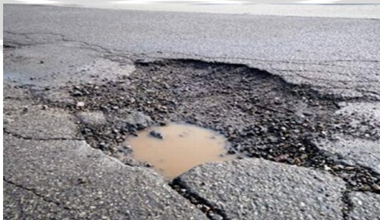
Gambar 1.1 Lubang pada Jalan
