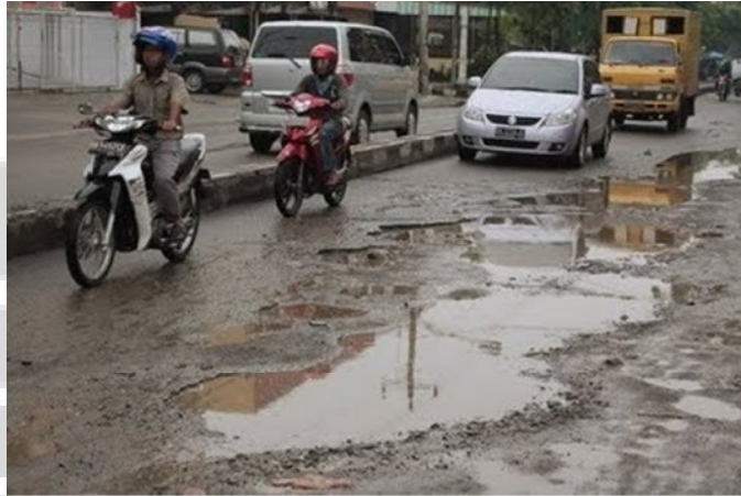
Gambar 1.2 Ruas Jalan yang Rusak dan Berlubang
